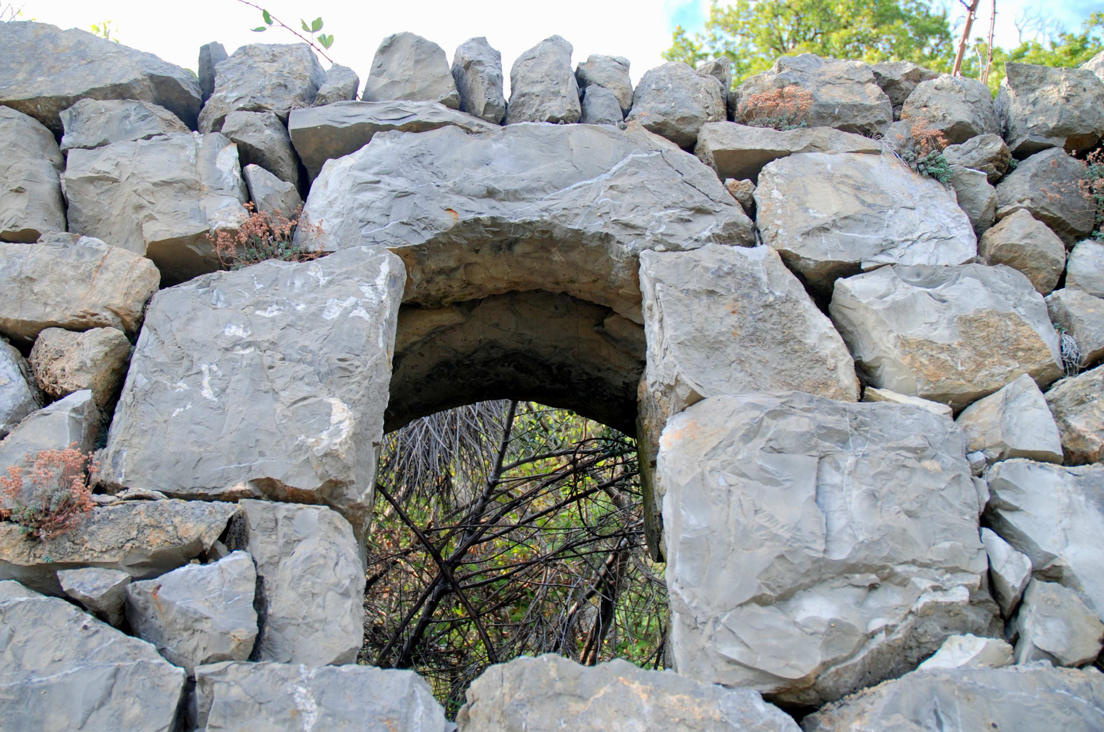
Ruine sud Baraba La Villette, embrasure fenestron façade sud-est
